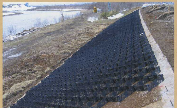
発注者：国土交通省能代河川国道事務所 工事名：米代川堤防改修工事
