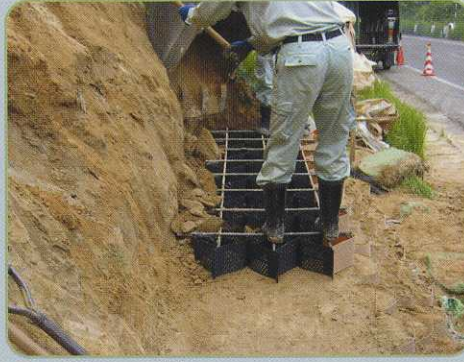
2. 設置・接続 補助枠を装着したジオウェブを所定の位置に設置し、相互をステープラーで接合する（1ヶ所当り3点）。
